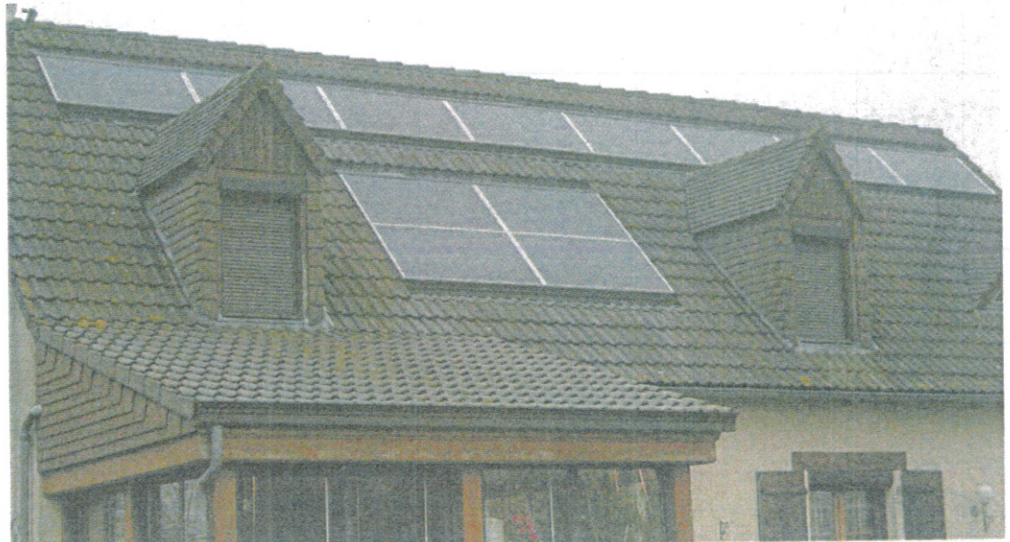
Les douze panneaux solaires sur le toit de la maison de M. Legoubey à Gouville-sur-Mer.
